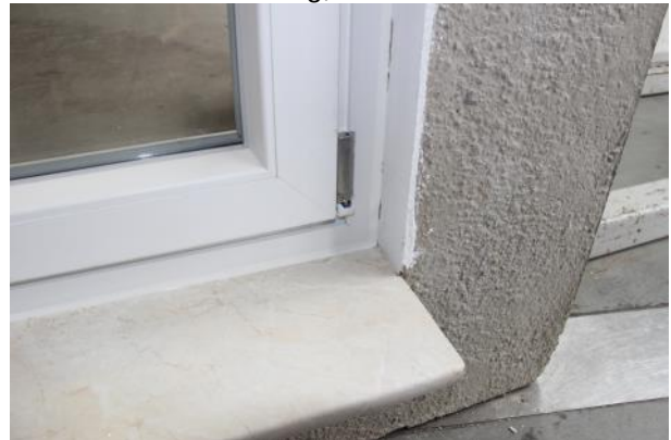
Bild 14 Prüffertiger Anschluss, innen, unten
