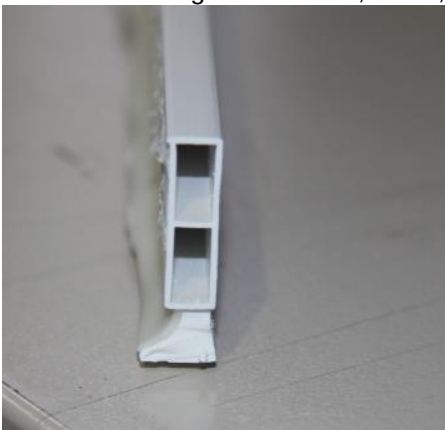
Bild 15 Querschnitt der Dichtleiste während der Demontage
